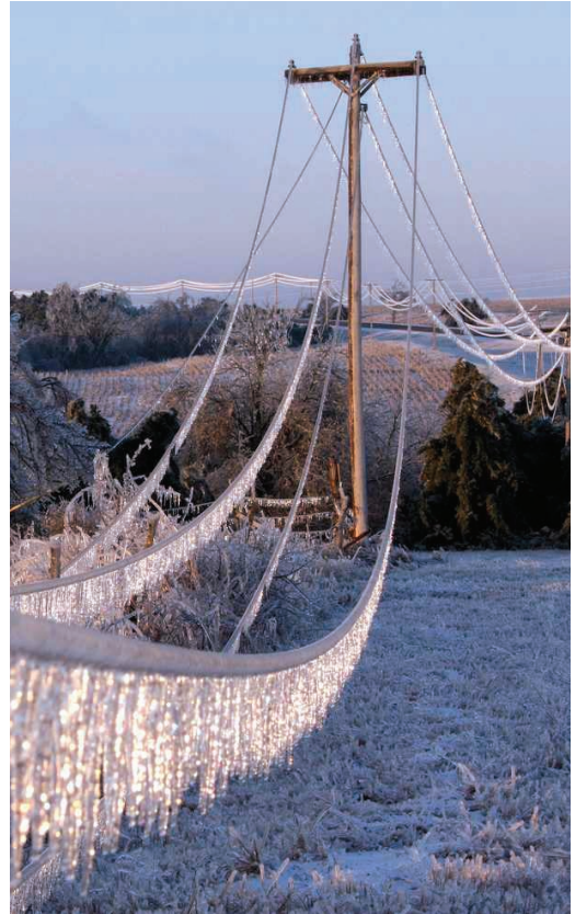
Es dauerte viele Tage, bis im Mittleren Westen der USA die Stromversorgung nach dem Eisregen im Dezember 2007 wiederhergestellt war.
